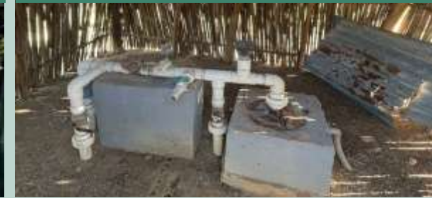
Infraestructura abandonada en La Guajira*
